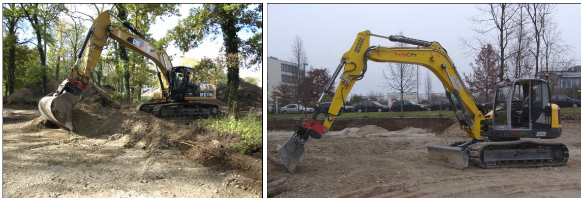
Abb. 6 Links: Kettenbagger beim Oberbodenabtrag. Rechts: 14 t Bagger für die Anlage von Arbeitsgruben.
