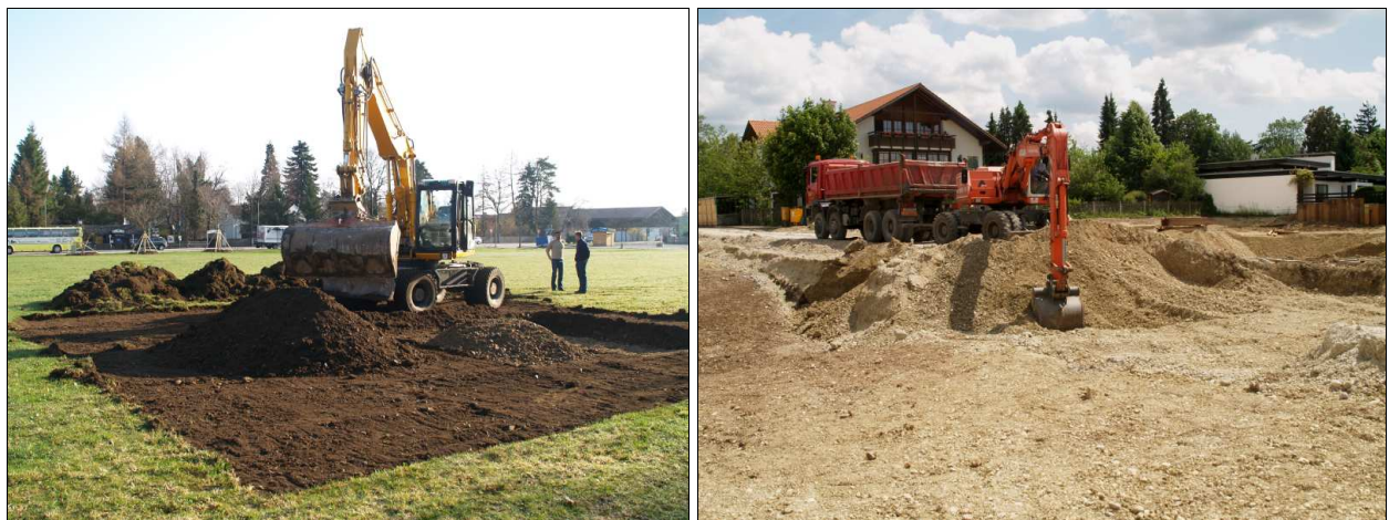
Abb. 4 Links: Beginn des Oberbodenabtrages mit ersten Schürfen. Rechts: Rückbau des Straßenbelages und Kiesbettes im Bereich des Hirtenweges.
