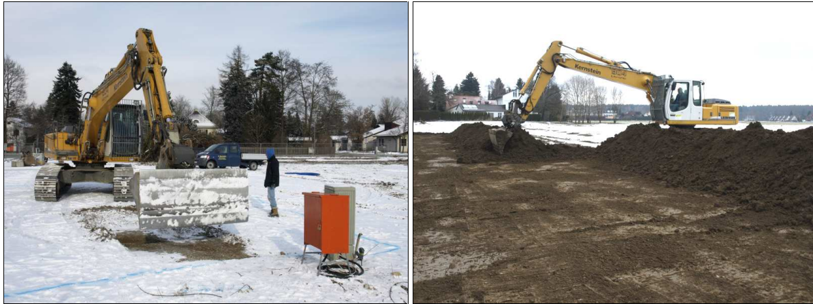
Abb. 1 Links: Arbeitsbeginn am 31.01.2012. Die Fläche für den Baustellencontainer wird hergerichtet Rechts: Humusabtrag bis auf Oberkante der Rotlage.
