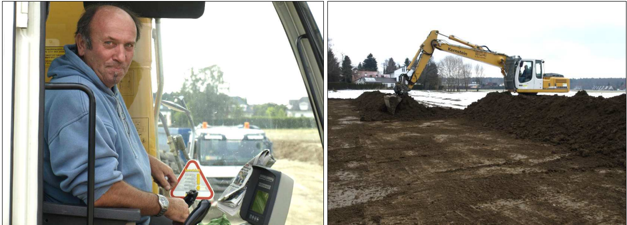
Abb. 6 Links: Baggerfahrer Herr Reindl. Rechts: Humusabtrag bis auf die Oberkante der Rotlage.
