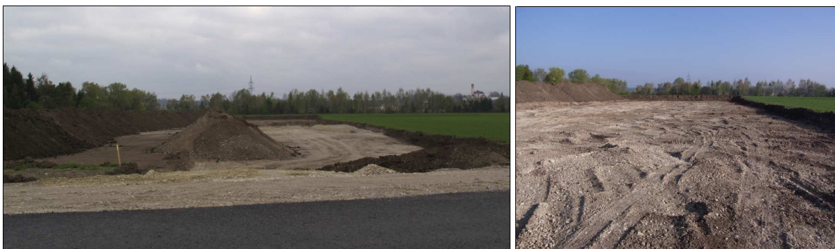
Abb. 2 Oberbodenabtrag ohne fachliche Aufsicht.
