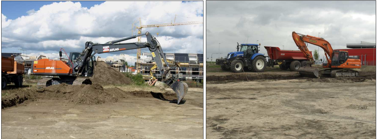
Abb. 7 Links: Anlage der archäologischen Feinplanie in der Nordhälfte, durchgeführt von Fa. Linner. Rechts: Anlage der archäologischen Feinplanie in der Südhälfte (Fa. Decker Transporte).
