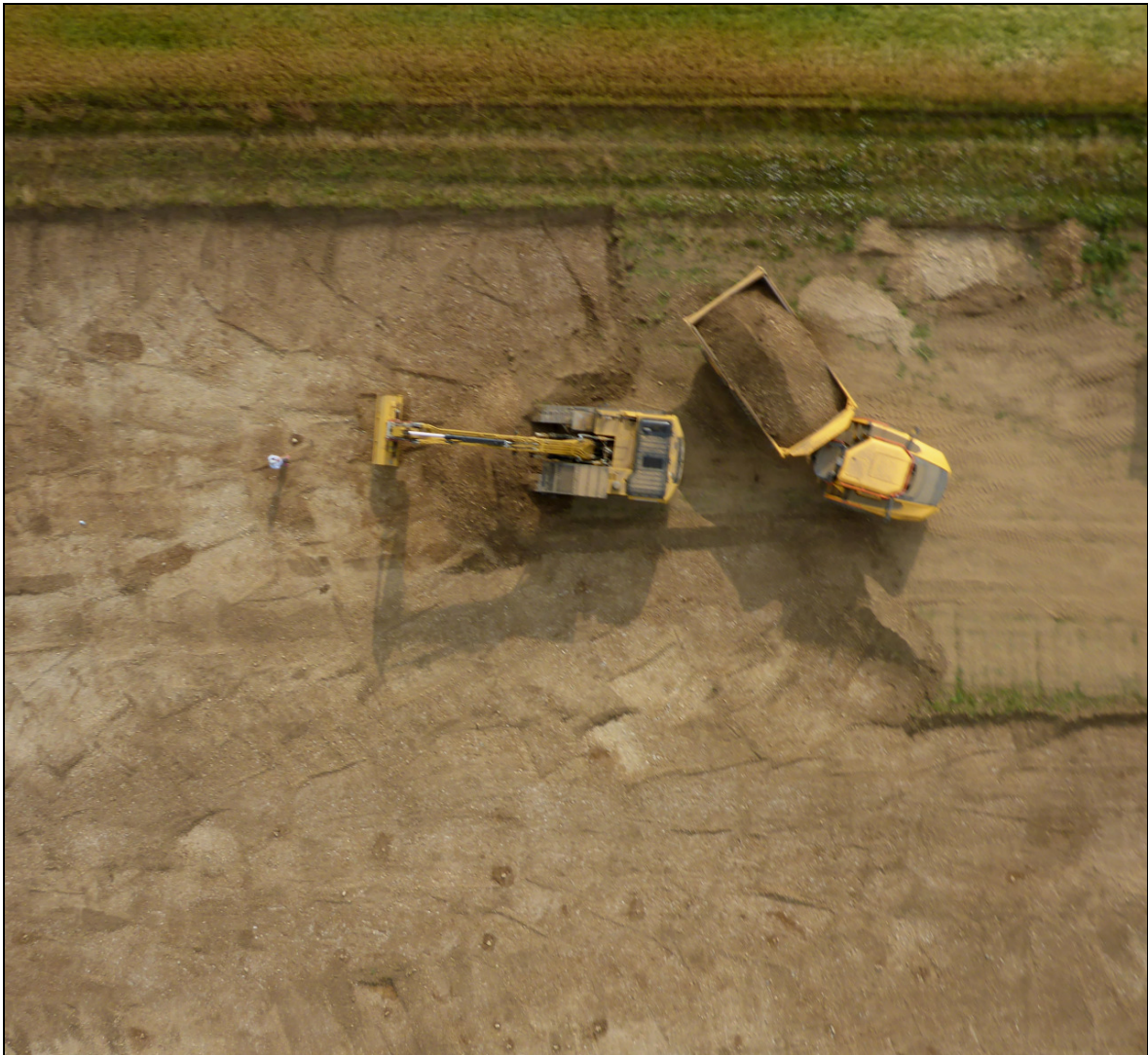
Abb. 9 Humusabtrag bis auf die Rotlage in der SO-Ecke des Grabungsareals. Luftbild mit dem Hebedrachen.
